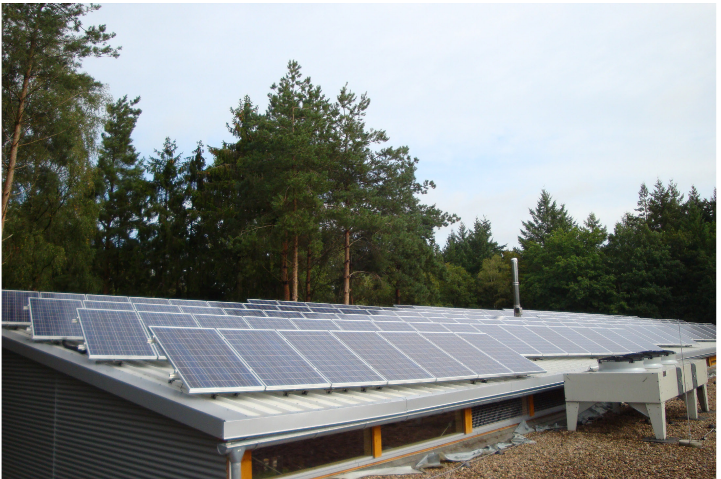
Abb. 14: Photovoltaik-Anlage auf dem Lagergebäude
